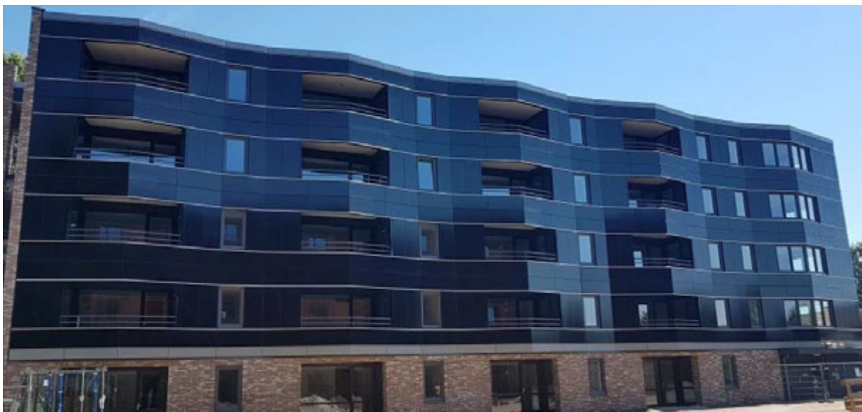
Figuur 37: BIPV panelen in de zijgevels van de appartementen De Willem & De Zwijger in Best (bron:Eigen Energie.net)
