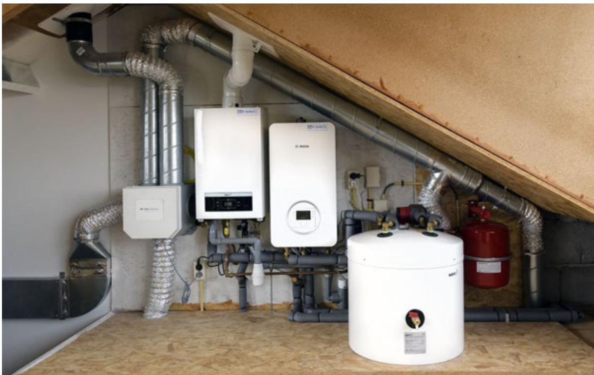
Figuur 35: Voorbeeld van een hybride warmtepompinstallatie met CV-ketel voor een woning (bron: Nefit-Bosch)
