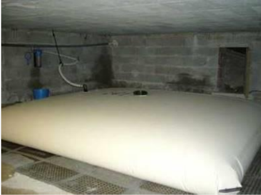
Figuur 90: voorbeeld van een hemelwaterzak, geplaatst in een kruipkelder (bron: Golantec)
