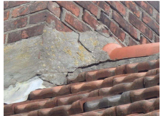
Oostelijke schoorsteenaansluiting scheurt los van de nokpannen
