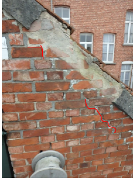
Scheurvorming door spatkrachten en weggevalen mortelaansluiting
