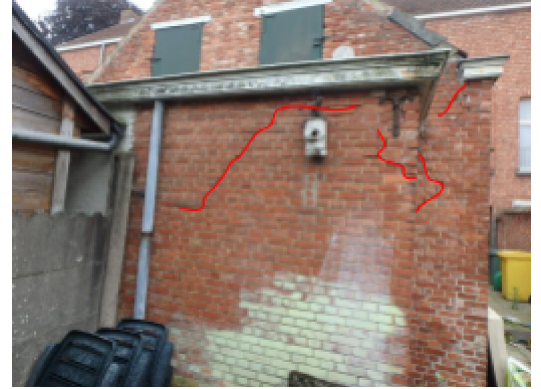
Zettingsscheuren in vleugels [2] en [3]
